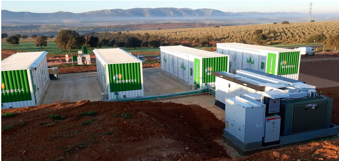
Vista de la Power Station y los contenedores de baterías suministrados por Ingeteam en Puertollano.
