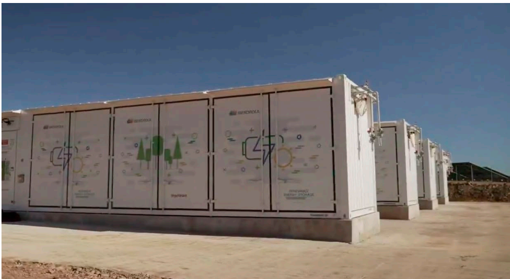
Vista de los contenedores de baterías en Puertollano.
