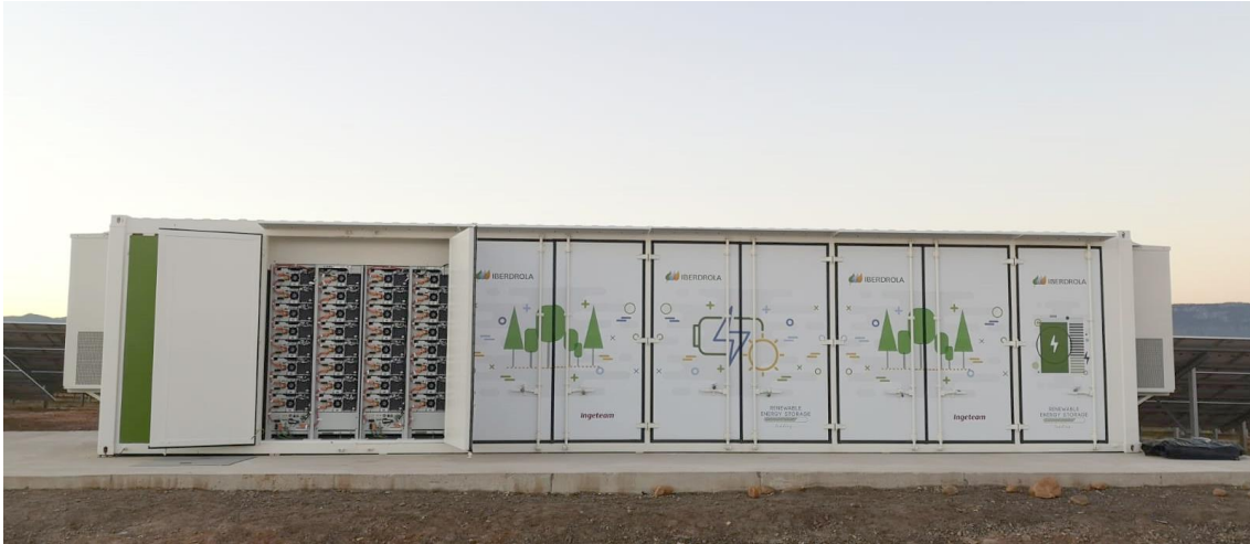
Vista del contenedor de baterías de 45 pies en Arañuelo III.
