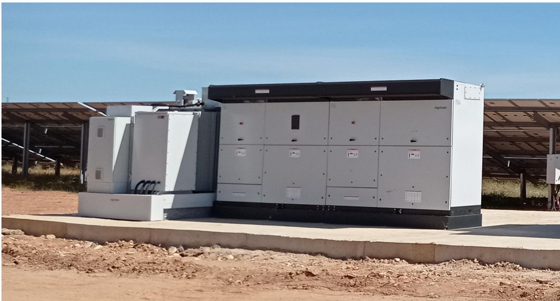
Vista de la power station de Ingeteam con el convertidor de baterías acoplado al inversor fotovoltaico en Arañuelo III.
