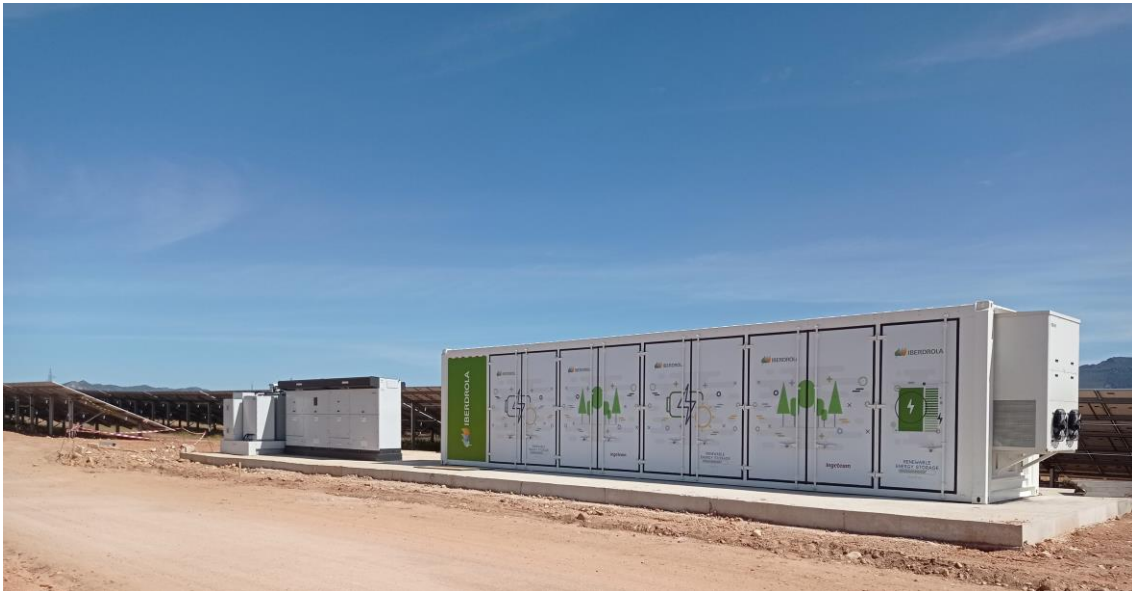
Vista de la Power Station y el contenedor de baterías de Ingeteam en Arañuelo III, Cáceres.
